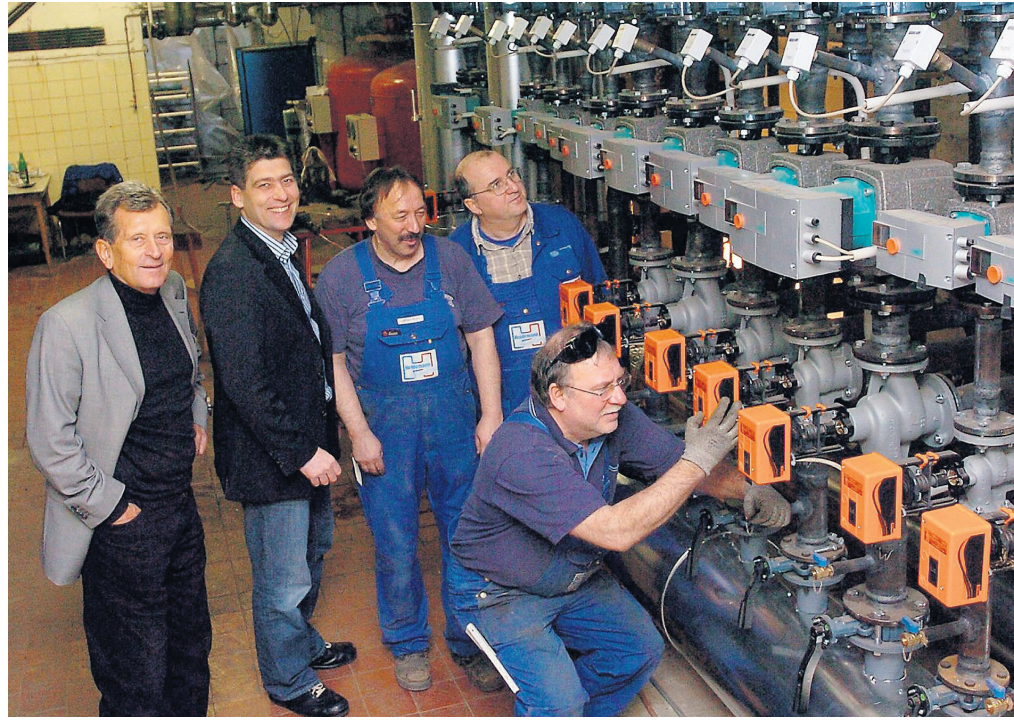
Im Keller eines Hagener Altenheimes installierten Uwe und Frank Heidemann mit ihren Mitarbeitern eine neue Heizungsanlage. RN-Fotos (2) Neubauer
